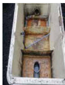
約5cm程の固形化した油脂、配管内にも確認。油脂引抜後投入開始。
